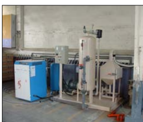
土壤及地下水污染藥劑灌注設備
