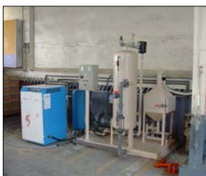
土壤及地下水污染藥劑灌注設備
