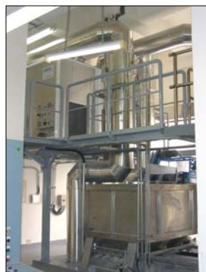
污泥乾燥系統工程
